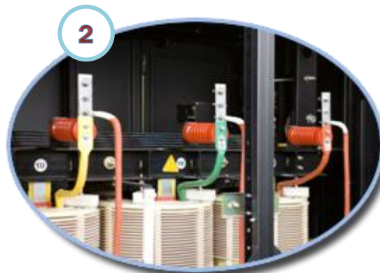
Кабельные вводы трансформатора
